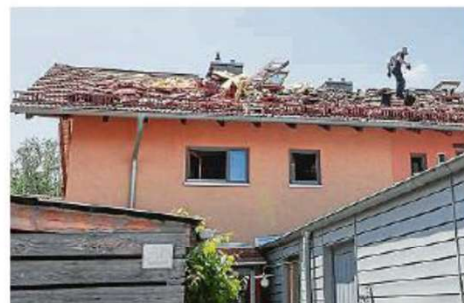
Dokumentation: Kripo-Beamte machten Fotos von den Spuren des Einsatzes und des Feuers im Dach.
